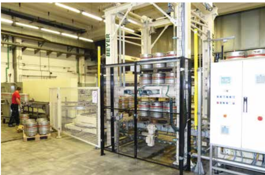
Die erste Beyer-Maschine bei der Köstritzer Brauerei war der Keg-Entstapler. Die oberen Keg-Paletten werden so weit angehoben, dass die unterste herausfahren kann.
